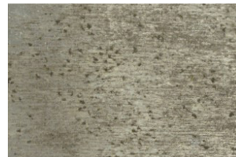
Visar en rostfri plåt som har angripits av korrosion.
